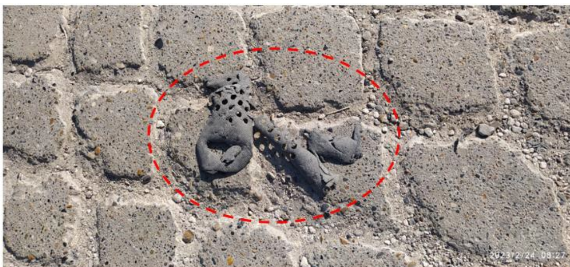
Figura 7. Material geosintético expuesto en la superficie de la calzada derecha del tramo de Vía La Carolina. Fuente: Tomado de oficio AMC-OFI-0027579-2023
