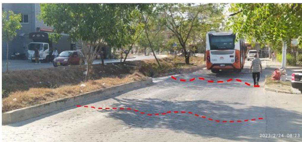
Figura 5. Ondulaciones por deformación de la superficie en la calzada derecha del tramo de Vía La Carolina. Fuente: Tomado de oficio AMC-OFI-0027579-2023
